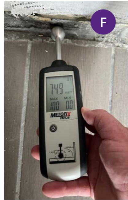
F Mesure de l'humidité au bas, où le mur et le sol se rencontrent, pour comparaison. Nous obtenons des valeurs jusqu'à 75%.
