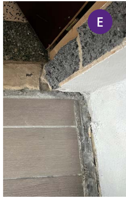
E Joint de dilatation manquant entre le sol et le mur
