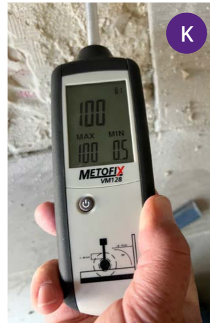
K Mesure d'humidité au niveau de l'évacuation d'eau. Ici, nous obtenons des valeurs de 100% d'humidité.
