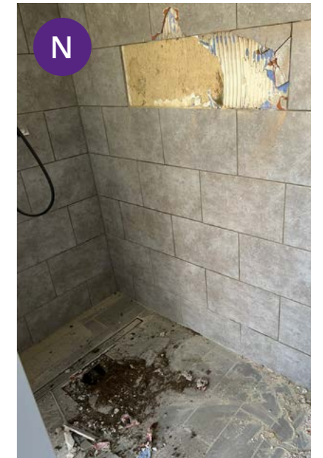
N Vue générale des points critiques.
