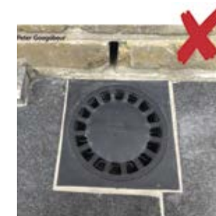
1. Asymmetrisch voegbeeld rondom een afvoerkolk (niet aanvaardbaar).
